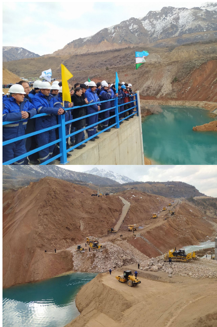
Kafedra professor-o'qituvchilarining Toshkent viloyatidagi Pskom suv omborining qurulish maydoniga tashrifidan foto lavhalar
